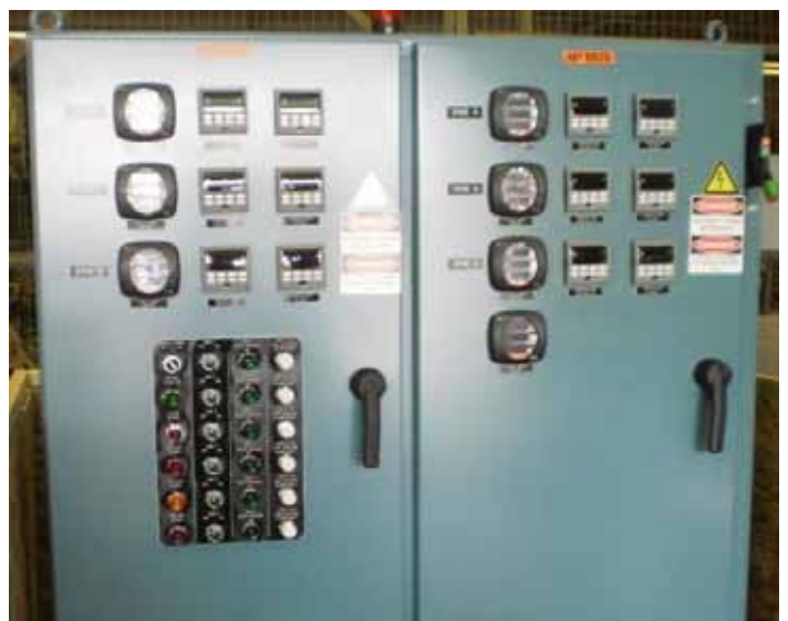
Horno a gas de 5.000 lb./hr con bóveda radiante
